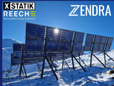
Testanlage NandroSolar, ewz, Systemlösung ALPIN QUATTRO®
