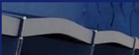
Im Sturm verbogene Rahmen von Standardmodulen
